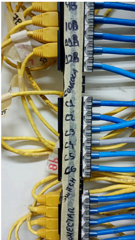
Etiquetas puertos consola C01 a C06
